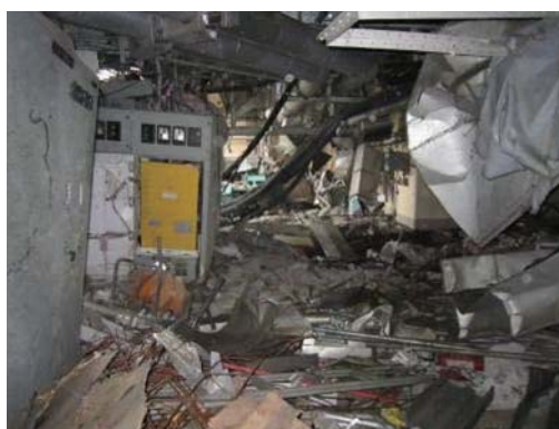
もっとも被害が軽かった4号機原子炉建屋3階の惨状。床が変形し、あたりは瓦礫が散乱している。現場は防護服を着用して入れられる線量。しかし、事故後2年近くも経っているが、まだ本格的な作業環境にはない。なお3階は崩壊している床もある。
