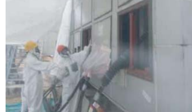
この仮設配電盤が使用済み核燃料プール、共用プールの核燃料冷却用電源供給の命綱。実際には仮設のタコ足配線が繋がっていた。これだけではない。応急処置仮設だらけの敷地内では様々な危機が防がれている。
