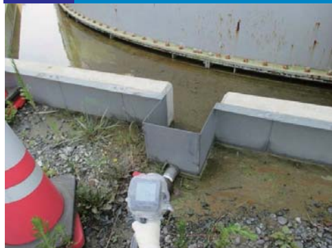
タンク No.12 北側の排水井と漏洩状況 (原子力保安検査官撮影)
