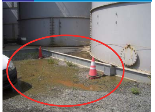
タンク No.12 東側の漏洩状況 (東電資料)
