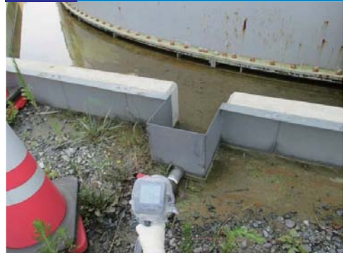
タンク No.12 北側の排水弁と漏洩状況 (原子力保安検査官撮影)
