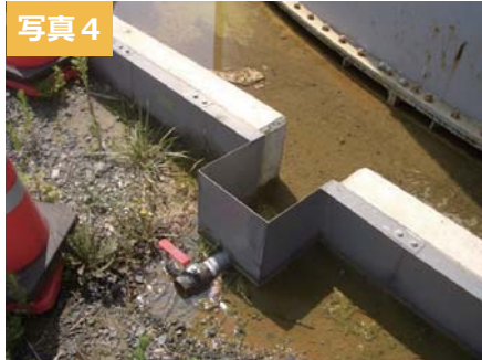
写真4 漏洩した高濃度の RO 汚染水 (東電発表写真より8月19日～20日撮影)
