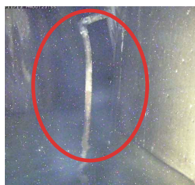
【画像1】格納容器下から延びているサンドクッションドレン管が壊れて曲がっている
