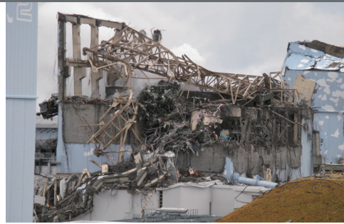
【写真引用】図 1・2、東京電力 web サイト「写真・動画集」より
